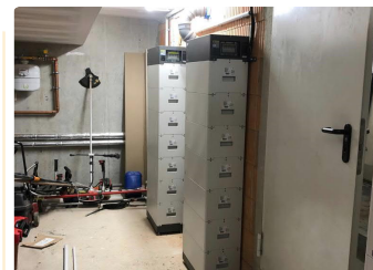
Größerer Batteriespeicher mit ca. 40 kWh Kapazität
